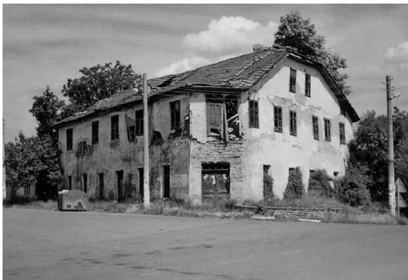
Къщата на Топалийски в разруха. Миланово, 2008 г.
